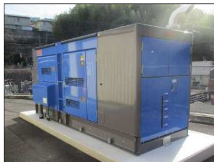
横井第2加圧ポンプ場非常用発電機
