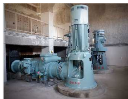
三野浄水場第5水源3号取水ポンプ
