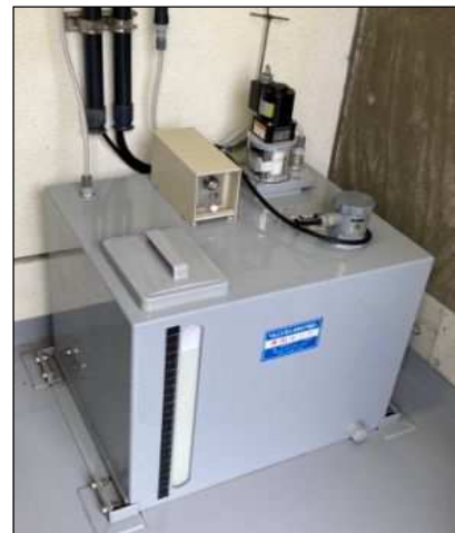
次亜塩素酸ナトリウム注入設備
