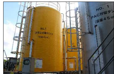
次亜塩貯留タンク/三野浄水場
