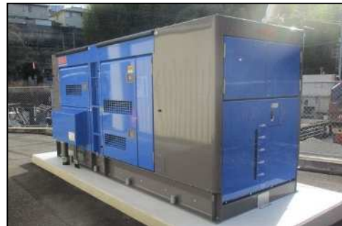
非常用発電機/横井第2加圧ポンプ場
