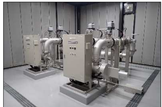
紫外線処理設備/矢原浄水場
