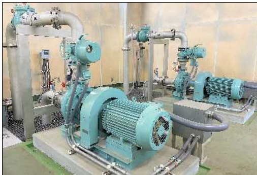
江並加圧ポンプ場
