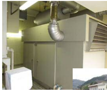
非常用発電機 (参考：金川取水場)
