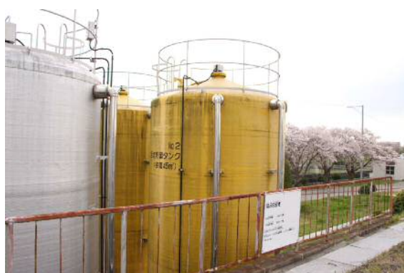
三野浄水場次亜塩貯留タンク
