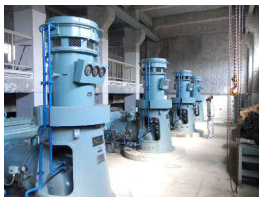
三野浄水場第5水源取水ポンプ
