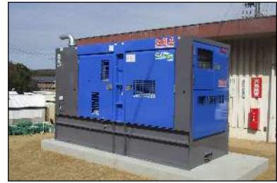
非常用発電機（妹尾加圧ポンプ場）
