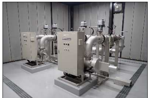
紫外線処理施設(矢原浄水場)
