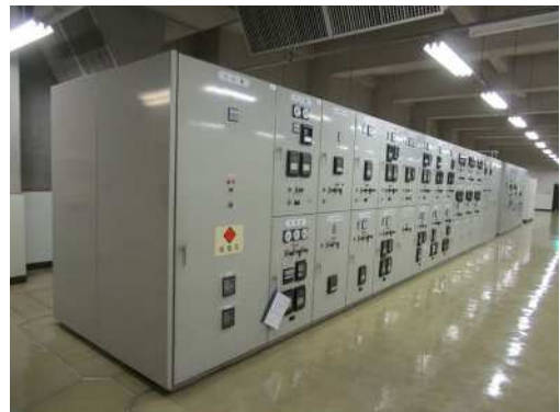
旭東浄水場受配電設備
