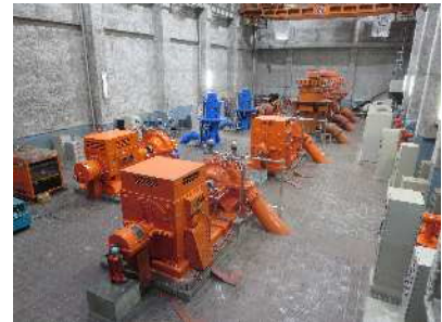
三野浄水場 送配水ポンプ棟
