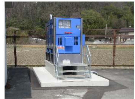
非常用発電機(吉備津加圧ポンプ場)
