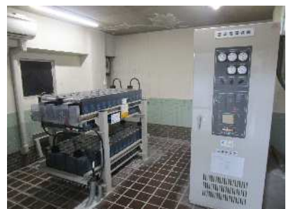
三野浄水場 特別高圧受変電設備
