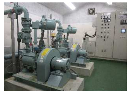
上高田加圧ポンプ場
