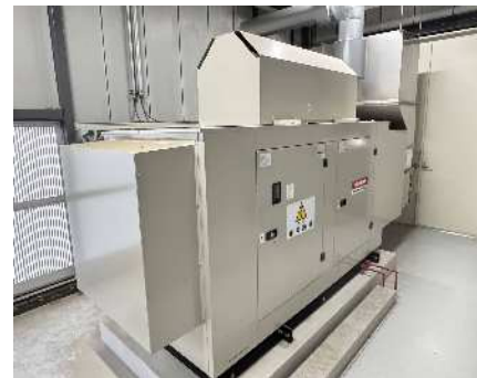
非常用発電機(矢原浄水場)
