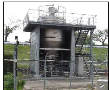
三野浄水場 粉末活性炭貯留槽
