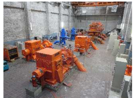
三野浄水場 送配水ポンプ棟
