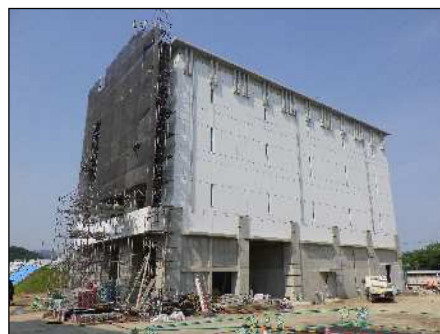
三野浄水場新脱水機棟
