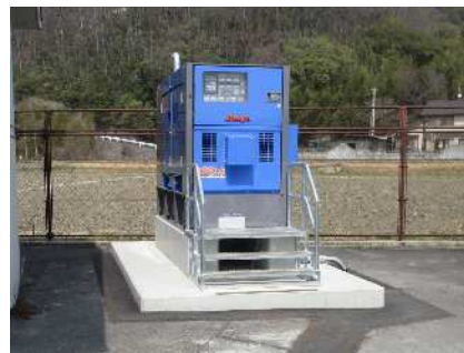
吉備津加圧ポンプ場非常用発電機
