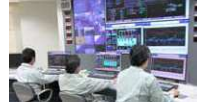
中央管理棟監視室
