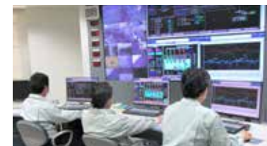
中央管理棟監視室
