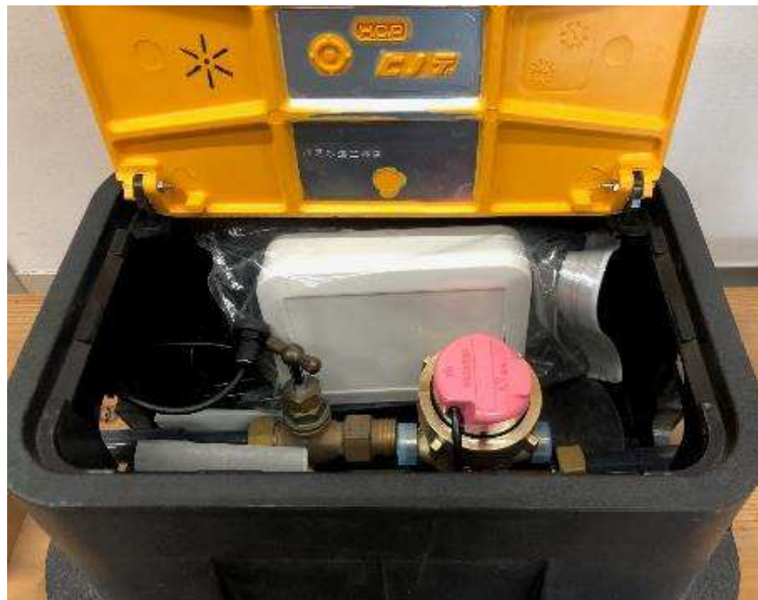
【図2】スマートメーターの設置例
