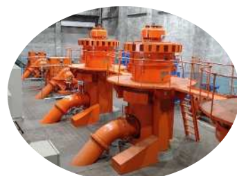
浄水場の効率運転による省エネルギー化に努めています
