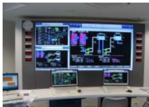
更新された三野浄水場集中監視制御設備
