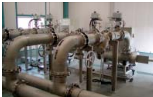
牟佐浄水場紫外線照射によるクリプトスポリジウム不活化設備
