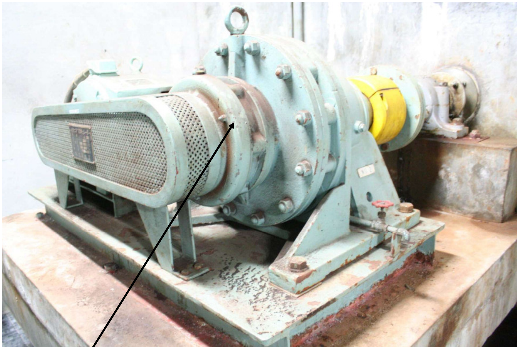
[三野浄水場]薬品沈でん池の駆動部(その2)
