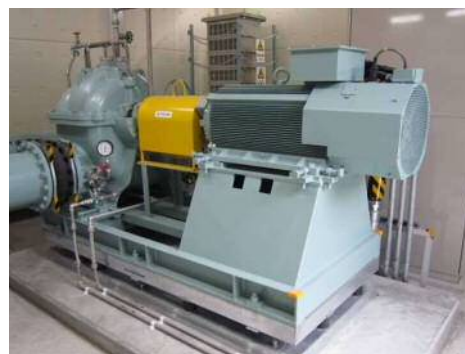
小水力発電設備
