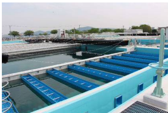
三野浄水場薬品沈でん池
