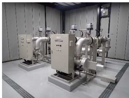
紫外線処理施設（矢原浄水場）／令和元年度
