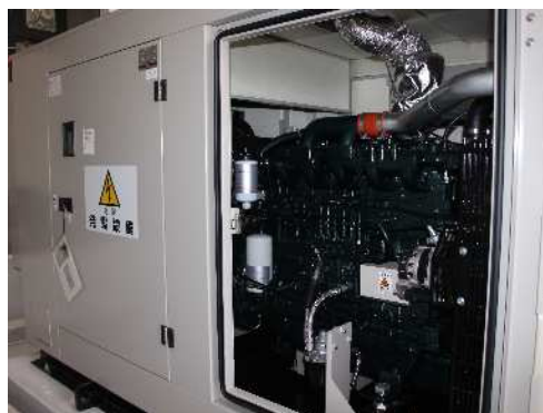
非常用発電機（矢原浄水場）／令和元年度完工
