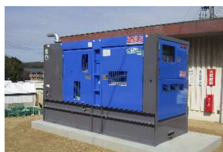
非常用発電機/妹尾加圧ポンプ場
