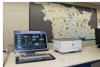
集中監視制御設備/旭東浄水場
