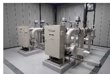
紫外線処理設備/矢原浄水場
