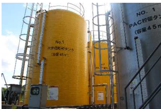
次亜塩貯留タンク/三野浄水場
