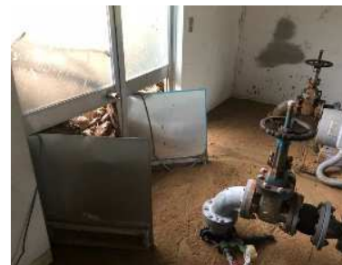
土石流による ポンプ停止
