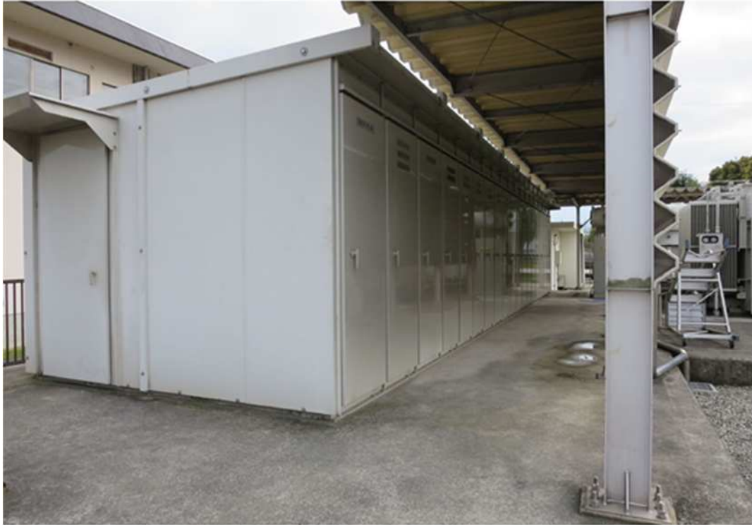
参考:三野浄水場 既設特高変電所 配電盤設備(屋外全天候型)
