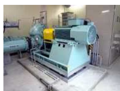
西大寺小水力発電設備
