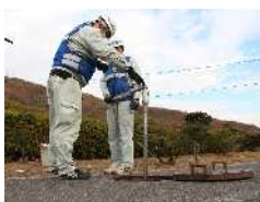
基幹管路の弁類点検
