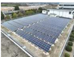
太陽光発電設備 (旭東浄水場PPA)
