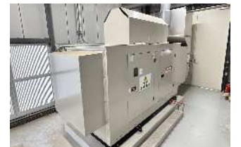
非常用発電機(矢原浄水場)
