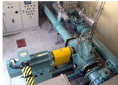
発電設備全景
